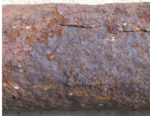
Slika 4. Otkrivena površina metala ekranskih cevi koje su podlegle erozionoj koroziji.
