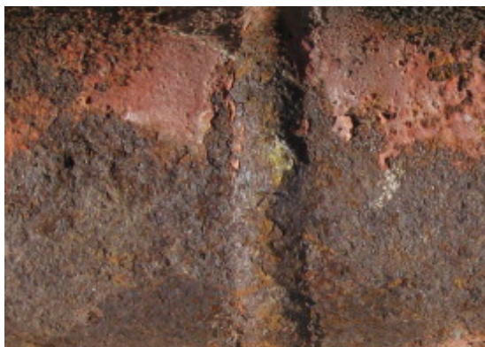
Slika 6. Ekranska cev nakon uklanjanja kamenca i produkata korozije.
